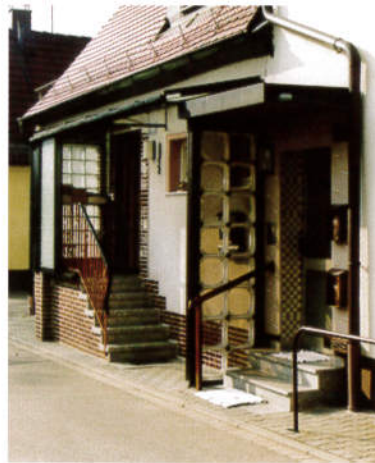
Negativbeispiel: Vordächer, Windfänge und Treppenanlagen dieser Art sind zu vermeiden.
