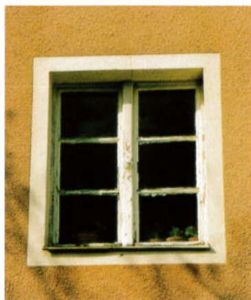
Positivbeispiel: Altes Fenster aus Holz mit althergebrachter Sprossenunterteilung und farblich abgesetzter Fensterlaibung.
