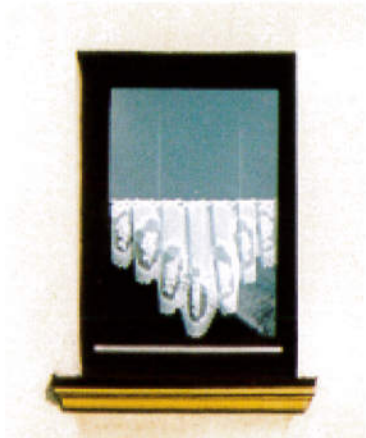
Negativbeispiel: Neues Fenster aus Holz wirkt im Gegensatz zu den alten geteilten Holzfenstern spannungslos und zu dunkel..
